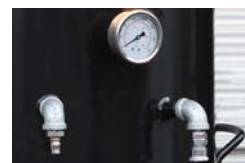
圧力メーター エアーチャック
